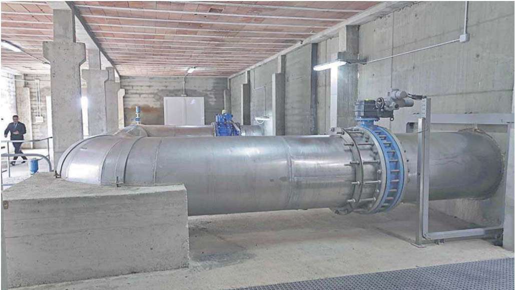
Tuberías de la Estación de Arenillas en Castellar de la Frontera (Cádiz) recientemente ampliada.
